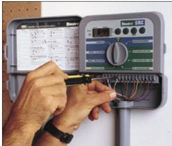
Usare dei cavi colorati per collegare le valvole al programmatore. Prevedere un cavo per ogni valvola più un cavo comune a tutte.
