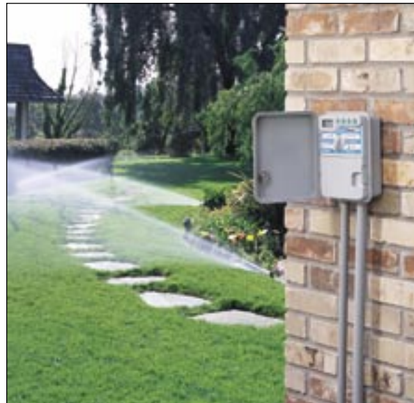
Il programmatore registra i giorni, le ore di avvio dei cicli ed i tempi di irrigazione per ciascun circuito.
